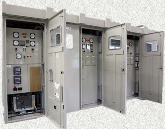
キュービクル式高圧受電設備
