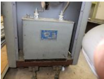
電気溶接機の側面に取り付けられた低圧コンデンサー
