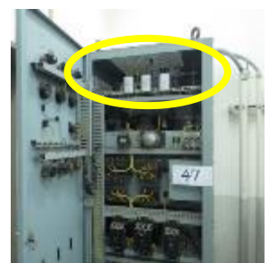
可変周波数電源装置に取り付けられた低圧コンデンサー
