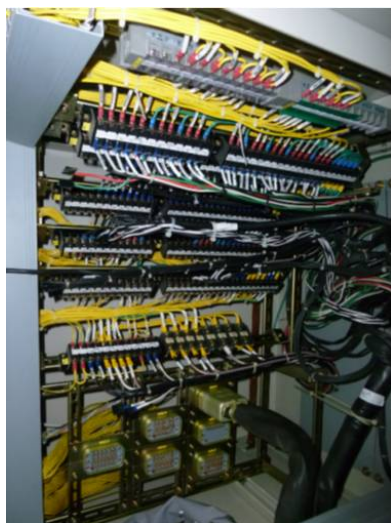
写真 32.制御盤下部からケーブル接続
